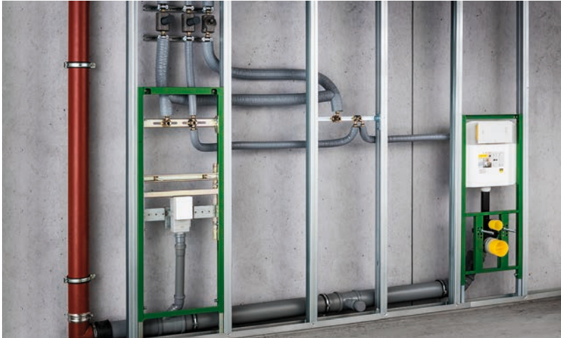
Fig. 1 - 18 Instalação em bruto com troços de arrefecimento
