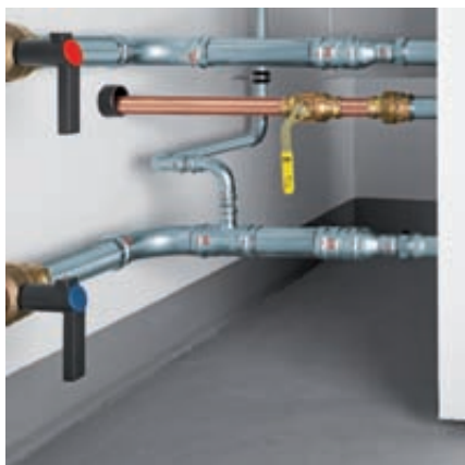
Ligação da caldeira: saída e entrada com Prestabo e torneiras Easytop. Ligação para gás com o Profipress G.
